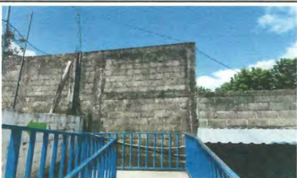
Foto 3: Área del muro perimetral que amerita demolición en su parte superior por presentar peligro a viviendas vecinas.
